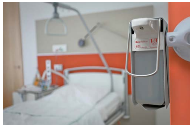
Lt. Vortrag Hygiene Symposium Ulm 12.4.11 tätig Prof. A. Kramer nur dann vergleichende Tests, wenn 4 Desinfektionsm.-Spender/Pat.Zimmer, da sind: vor + nach Tür im Zimmer, zwischen den Betten und im Bad!
